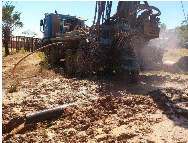
Figure 6 : Essai de soufflage
